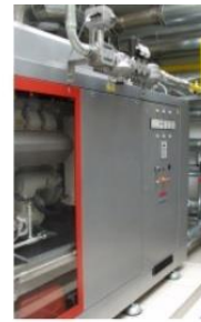
Biogas BHKW HellensteinBad aquarena & Iglauer Str.
